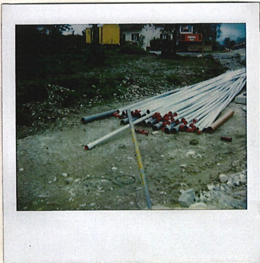
Diese Röhren sind für das Elektrische da.
